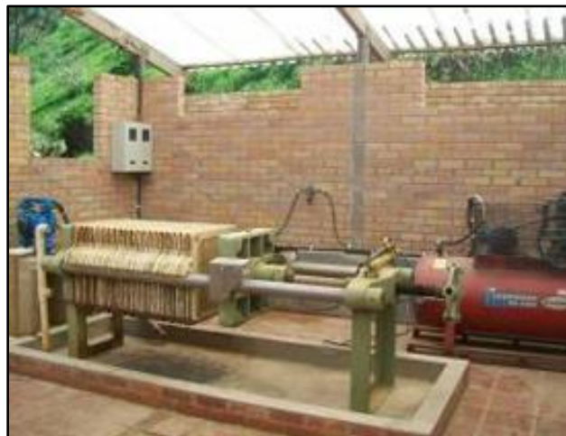
Figura 20. Sistema de filtración
