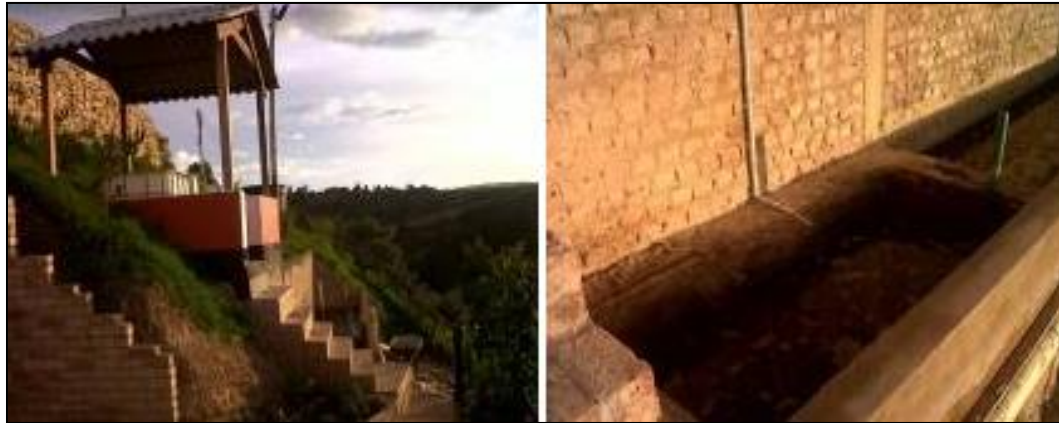
Figura 16. Tanque de dosificación de Peroxido de Hidrógeno Fuente: ServiTunja S.A E.S.P
