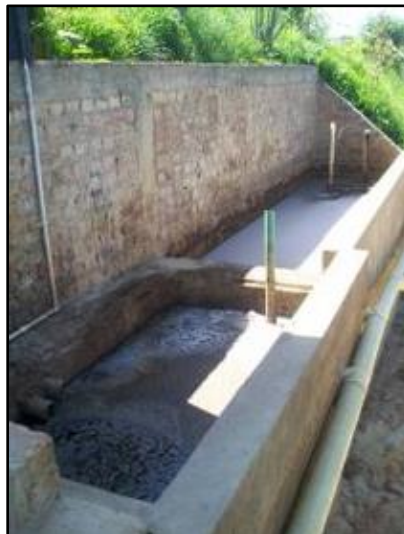
Figura 17. Tanque de almacenamiento y regulación de caudales Fuente: ServiTunja S.A E.S.P
