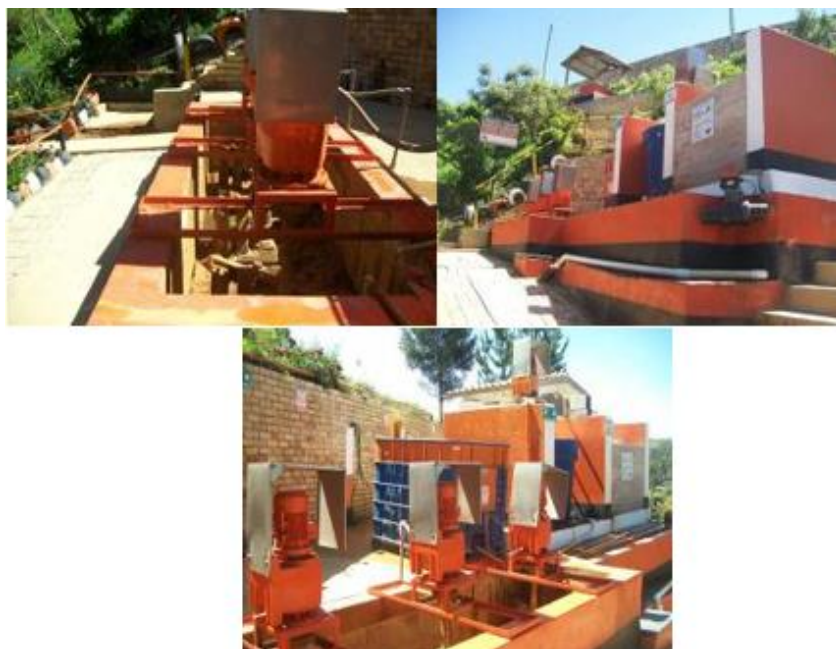
Figura 18. Floculador mecánico de paletas Fuente: ServiTunja S.A E.S.P
